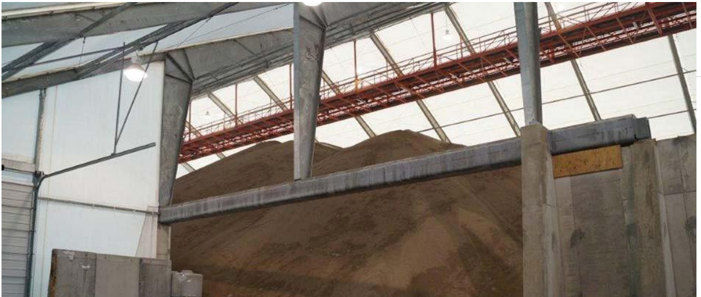
Figura VII: Las vigas auxiliares hacen posible tener aberturas excepcionalmente anchas en paredes laterales
