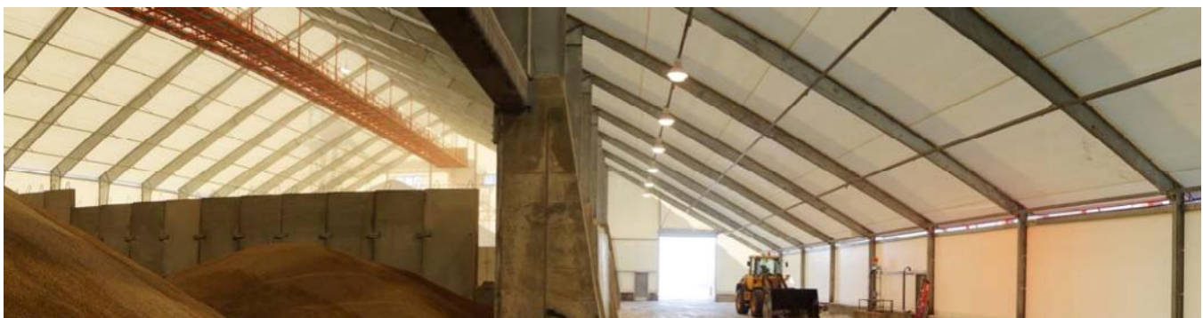
Figura 1: Almacenamiento ventilado de fertilizante
