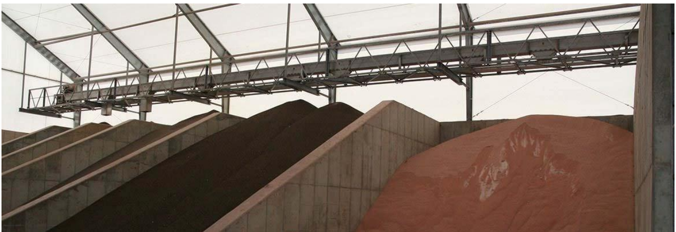
Figura VI: Sistema transportador para almacenamiento de productos básicos y fertilizantes
